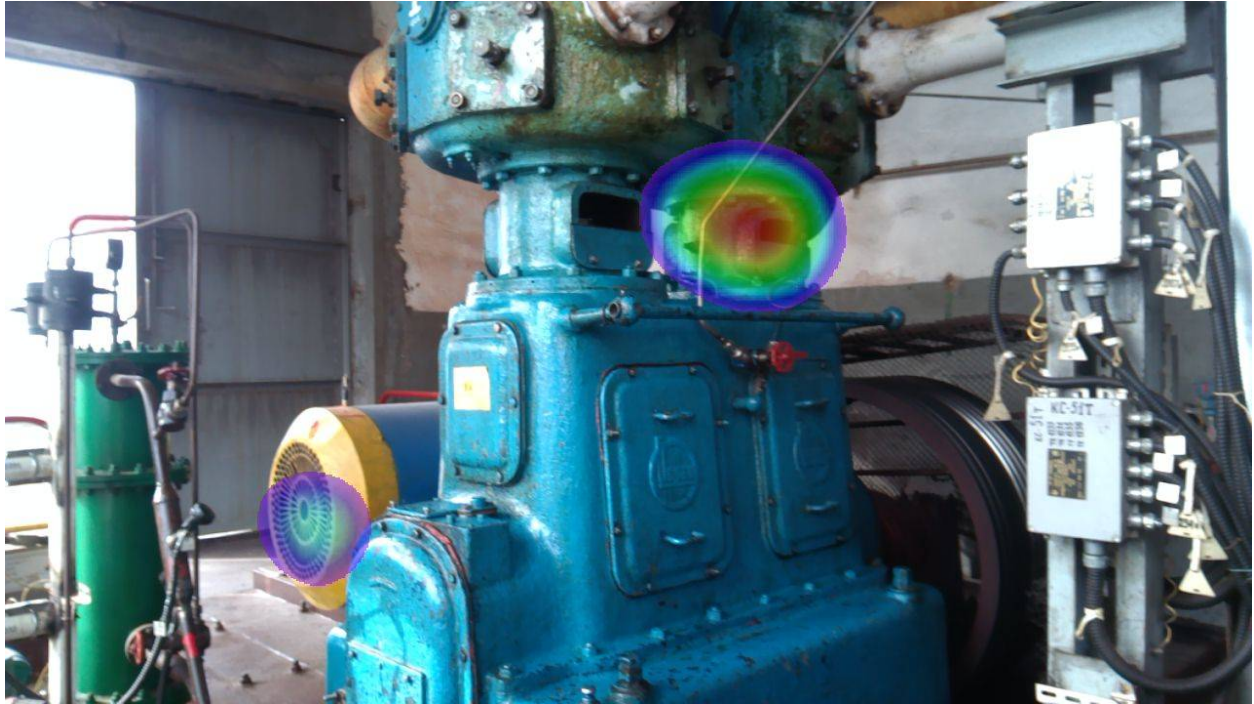
Место: Компрессорная, компрессор и электродвигатель. Источник: механический шум Оценка: корректность работы оборудования
