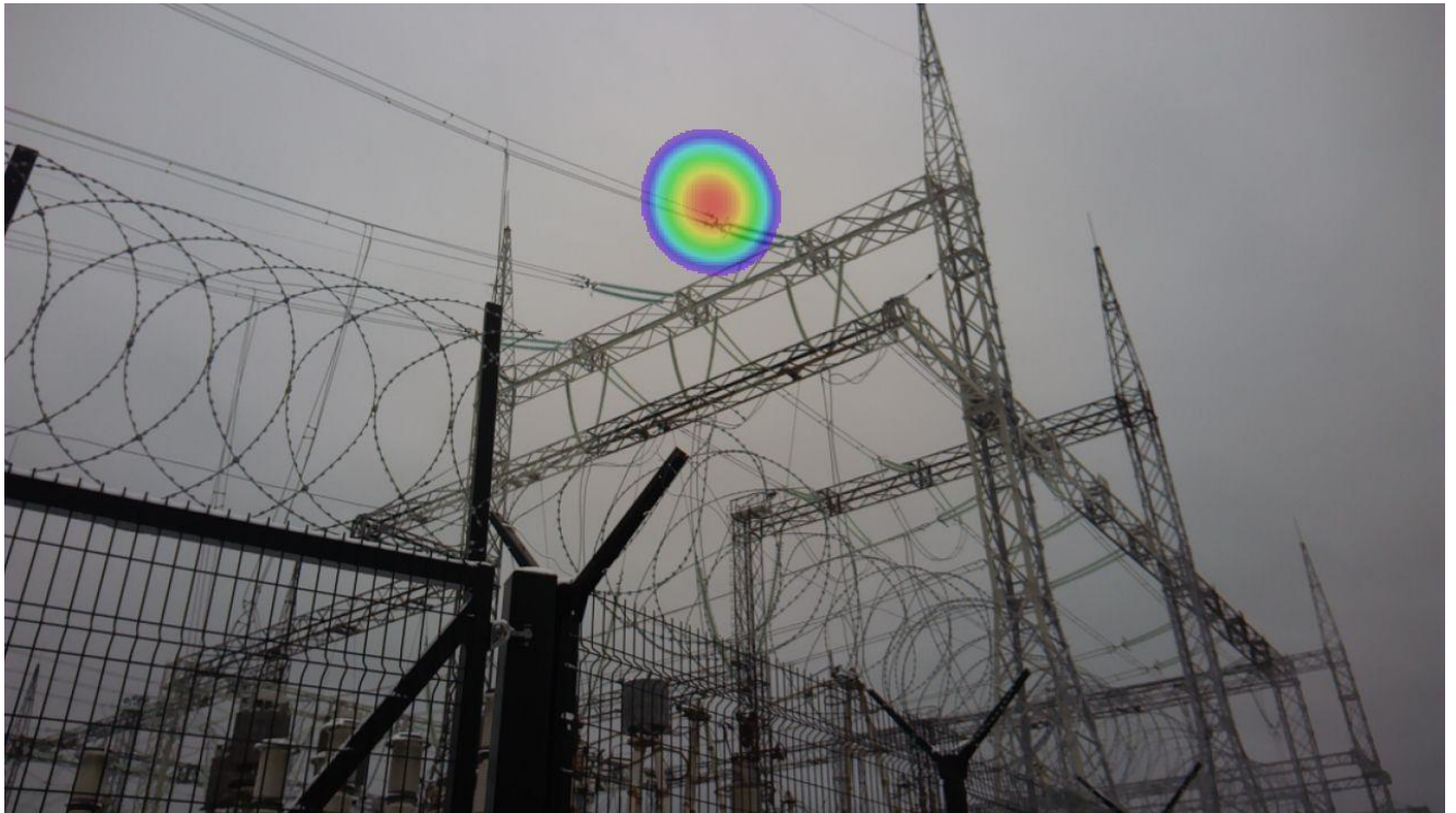
Место: ОРУ-500кВ. Присоединение к изолятору портала. Фаза «С» ВЛ-500кВ Источник шума: неизвестен
