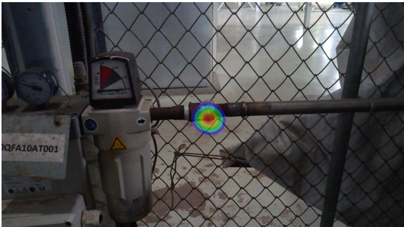
Место контроля: Трубопровод импульсного воздуха Источник шума: Поток воздуха Оценка: Пропуск в резьбовое соединение
