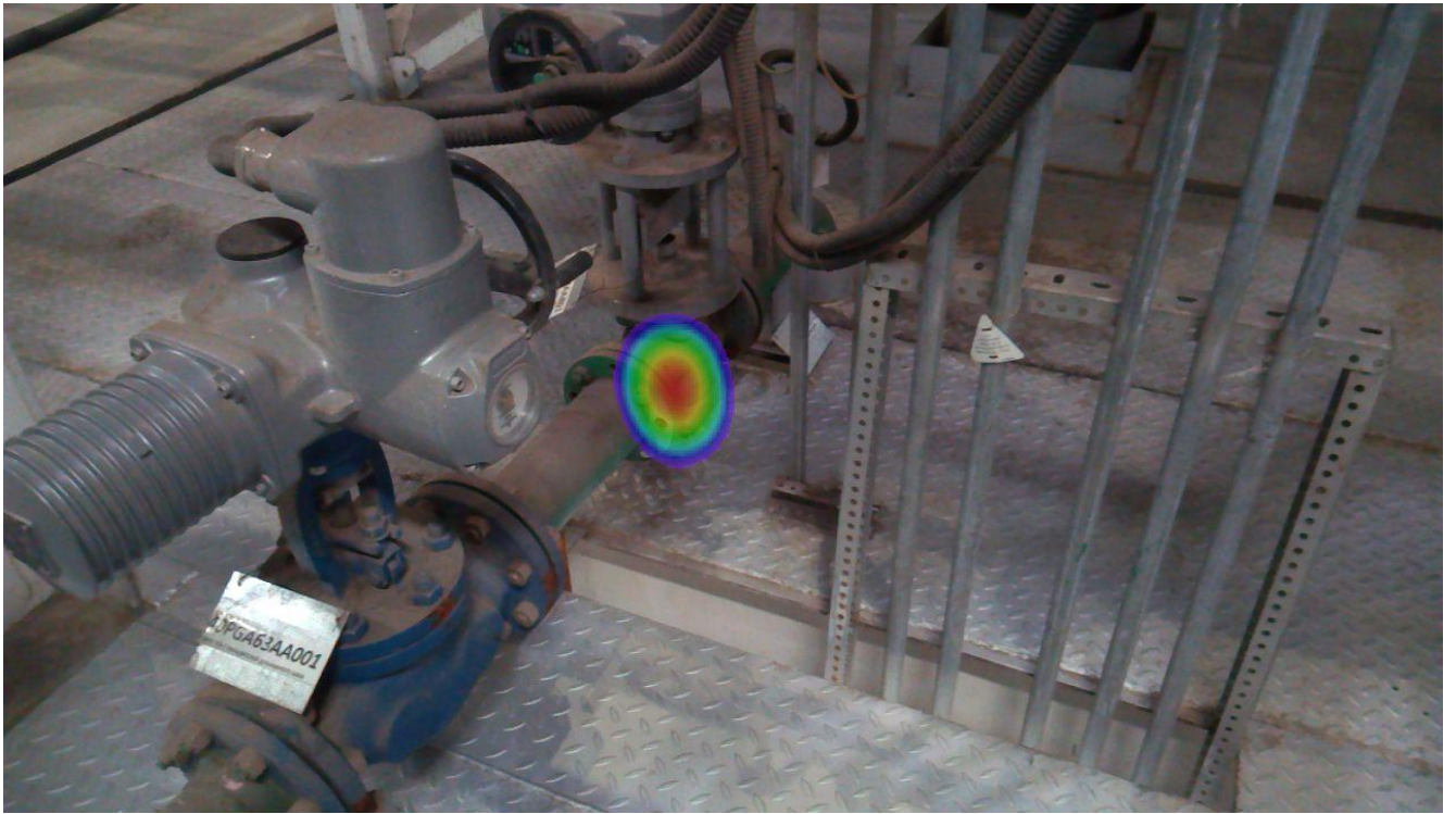
Место: Трубопровод охлаждающей воды Источник: Не выявлен
