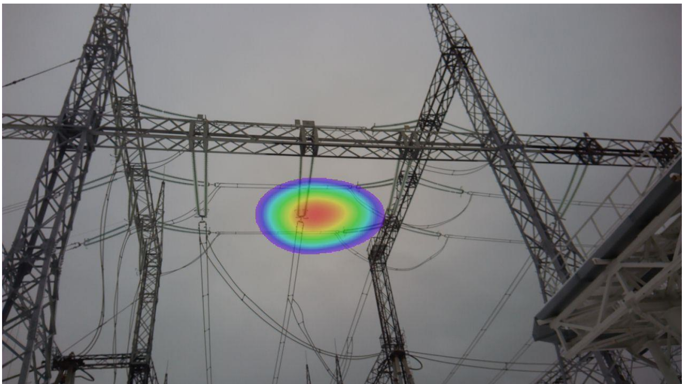
Место: Яч. №1 ОРУ-500кВ. Присоединение к изолятору портала. Фаза «В» ВЛ-500кВ Источник шума: неизвестен
